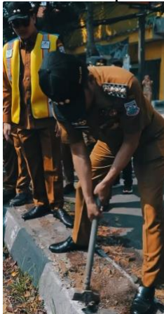
Gambar 1. Proses Pembongkaran Median Jalan oleh Wali Kota dan Wakil Wali Kota Cimahi. Sumber: Akun instagram @adhitiayudisthira
